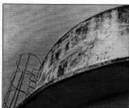
(b) Fissuras e infiltrações
