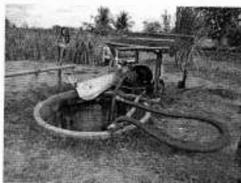
Figura 6. 18 – Captação do carro-pipa Prefeitura Municipal em Esguicho.
