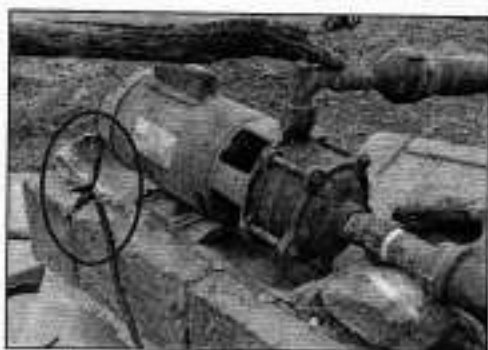
Figura 6. 31 – Instalações elétricas da bomba do SAA Fechado e Salgadinho. Fonte: CAERN (2013).
