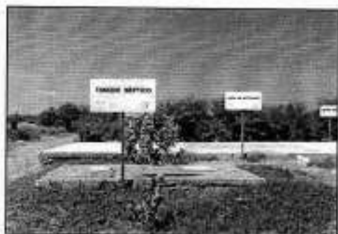
Figura 6. 48 – Tratamento Primário da Estação de Tratamento de Esgoto do Matadouro – tanque séptico. Fonte: CAERN (2013).
