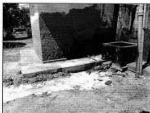
Figura 6.8 – Local de descarga do extravasor de água do tanque de reunião. Fonte: CAERN (2013).
