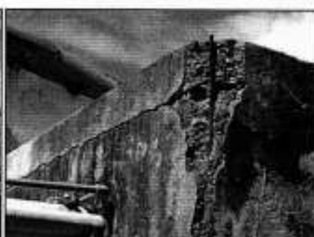
(b) Trincas, ferragem do concreto exposta
