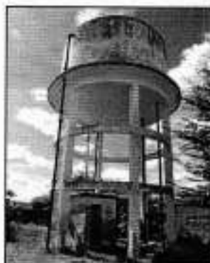
Figura 6.11 – Vista externa do reservatório do município de Ouro Branco-RN. Fonte: CAERN (2013).
