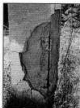
(a) Ferragem exposta
