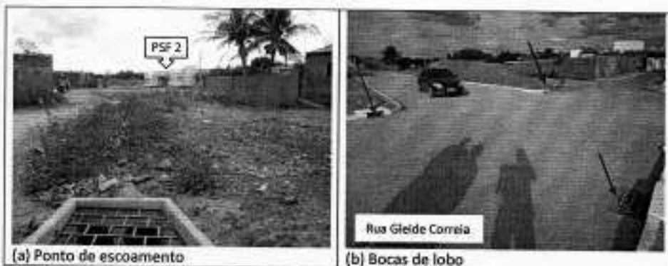
Figura 6. 56 – Dispositivos de drenagem implantados para não a lagar o PSF 2.
