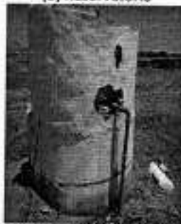
(d) Tubulação que segue para reservatório
