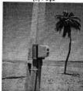
(c) Chave de comando elétrico da bomba
