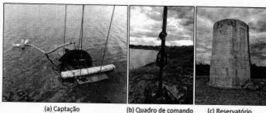
Figura 6. 20 – Equipamentos do sistema de abastecimento de água de Aroeiras. Fonte: CAERN (2013).
