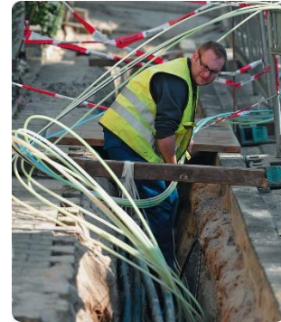
Figura 7. Instalação de cabos subterrâneos de fibra óptica na cidade de Bensheim, Alemanha (2014), a fim de acelerar o fluxo de informações e possibilitar a conexão rápida de pessoas e de empresas no mundo globalizado.
